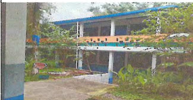
Pasamano con pintura deteriorada
