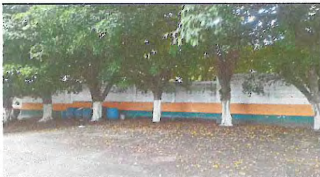
Pinchura de muro perimetral deteriorada
