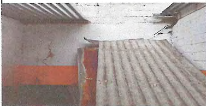
Pared de muro perimetral con grietas
