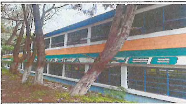
Pared de frente con pintura deteriorada
